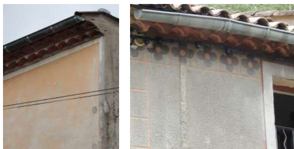
Bandeaux de teinte claire encadrants la façade, cernés par un filet sombre
